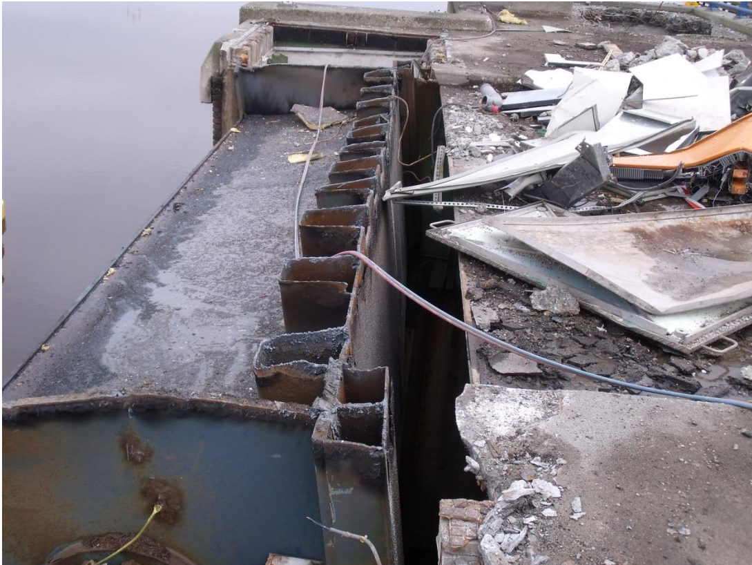
Brug gesloopt in 2013 de klap is verwijderd (beweegbaar gedeelte) het contragewicht hangt nog in de kelder.
